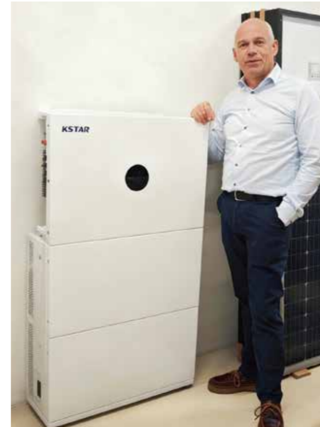
03 ESS-Projekt für Wohngebäude in den Niederlanden
