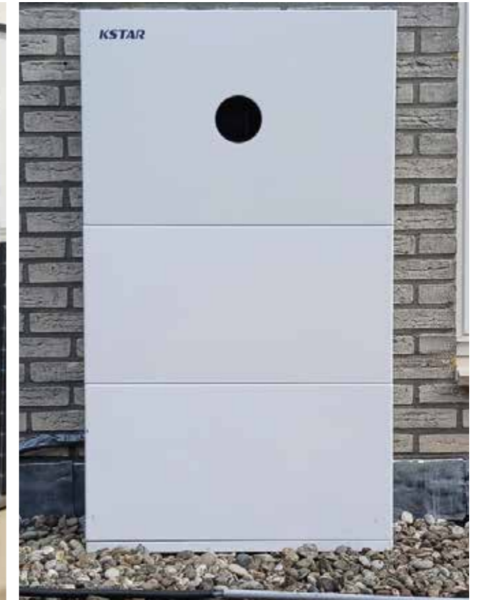
04 ESS-Projekt für Wohngebäude in den Niederlanden
