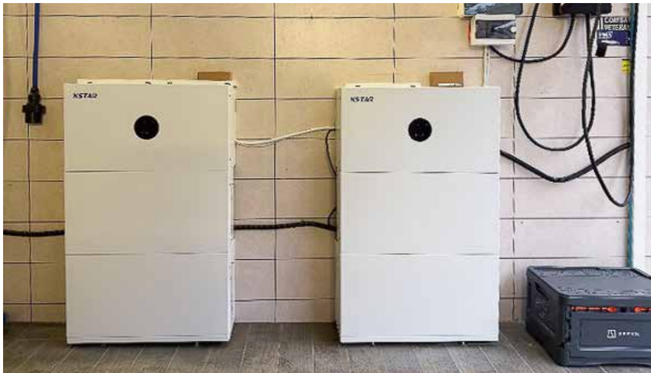
05 ESS-Projekt für Wohngebäude in der Ukraine
