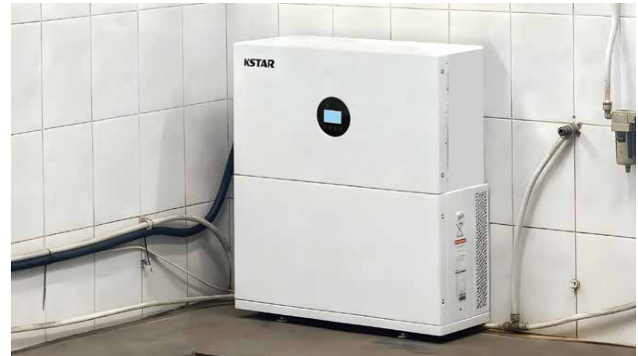
06 ESS-Projekt für Wohngebäude in der Ukraine
