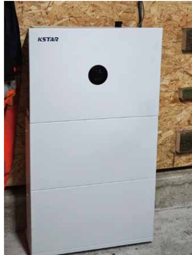
02 ESS-Projekt für Wohngebäude in den Niederlanden
